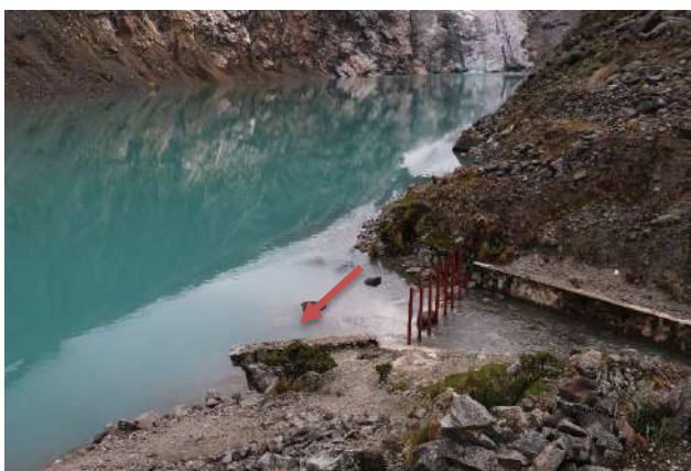
Figura 4. Las aletas del canal en proceso de deterioro. Foto: INAIGEM.
