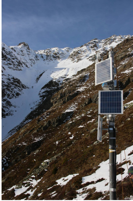
Figura 5: Sistema de detección y monitoreo de avalanchas instalado por Geopraevent alrededor de la montaña Piz Chapisun en el valle de Lower Engadin (Suiza).
