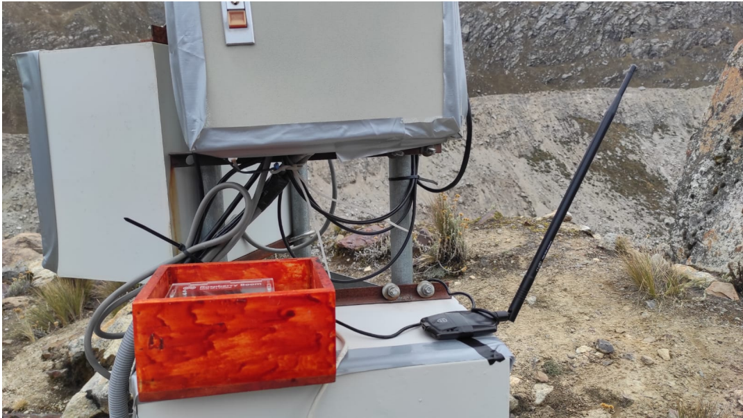
Figura 66: Instalación del sensor con el módulo externo de WiFi.
