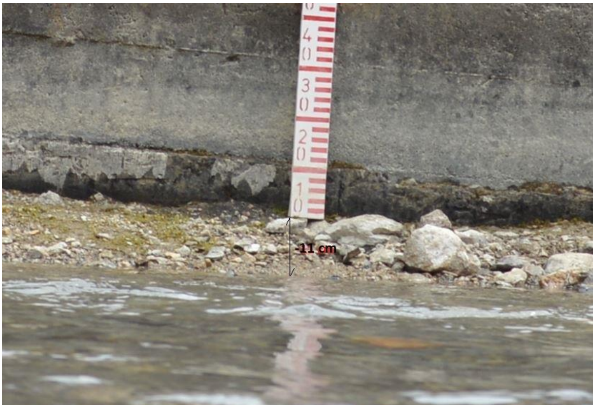
FOTOGRAFÍA N°02: El nivel de espejo quedó 11 cm por debajo del limnómetro.
