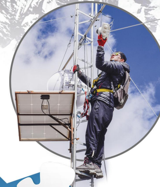
Cámara de video instalada en la laguna Palcacocha
