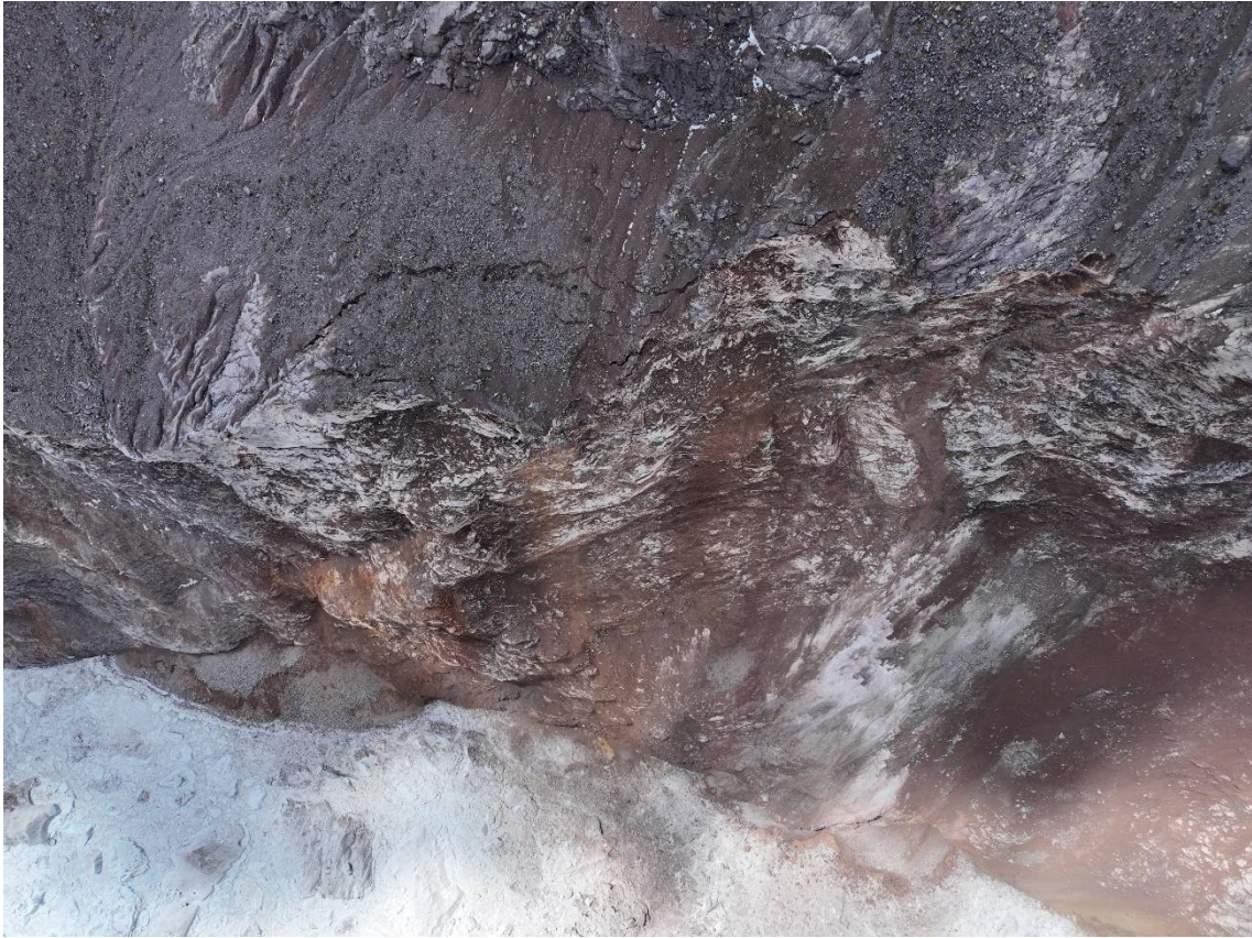
Figura 12. Zona 2, agrietamientos paralelos al borde y situado en pendiente casi vertical hacia la laguna.
