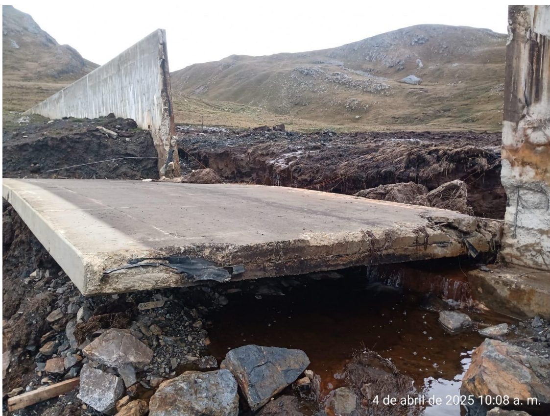
Figura 13. Zona de rotura de muro de contención.
