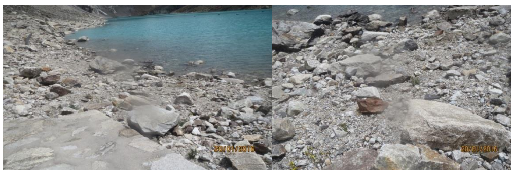
Foto N°16. El agua de la laguna se está presentando como causa principal de amenaza para la estructura de concreto, debido a la cercanía que tiene con la laguna, puede esta ser fácilmente socavada por el agua.
