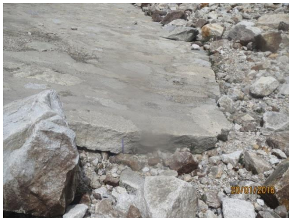
Foto N°21. Pie del talud del dique auxiliar, donde se observa levantada parte inferior de la loza, quedando la estructura vulnerable frente al proceso erosivo del agua.
