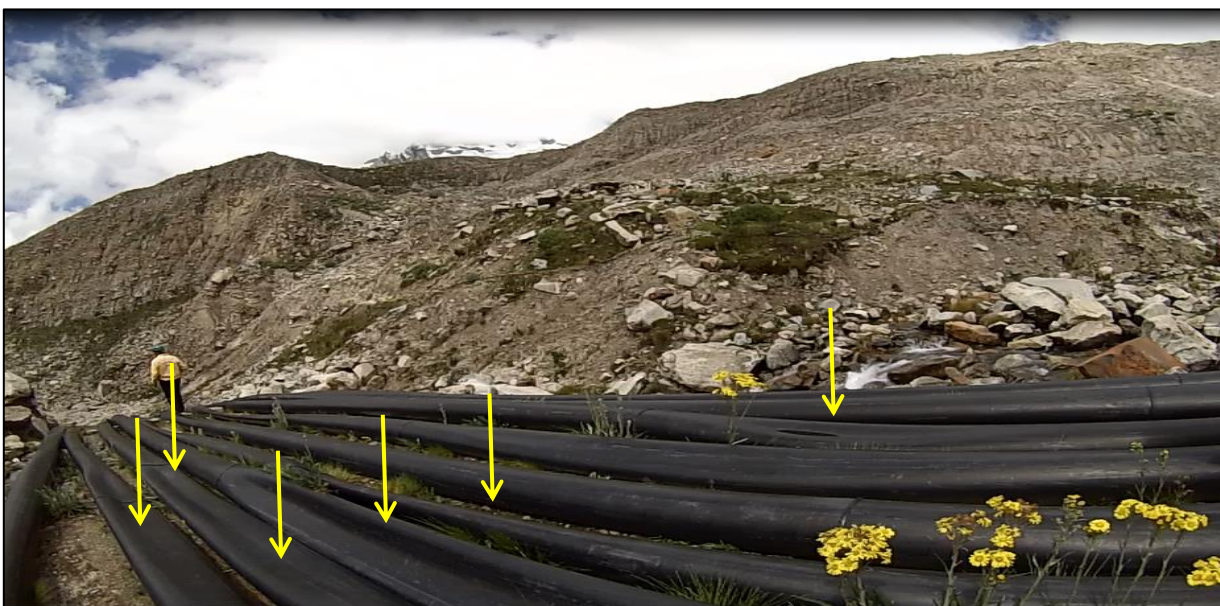
Fotos N°07, Vista de la tubería afectada por el fenómeno de cavitación en el sistema de sifonaje en la laguna Palcacocha.
