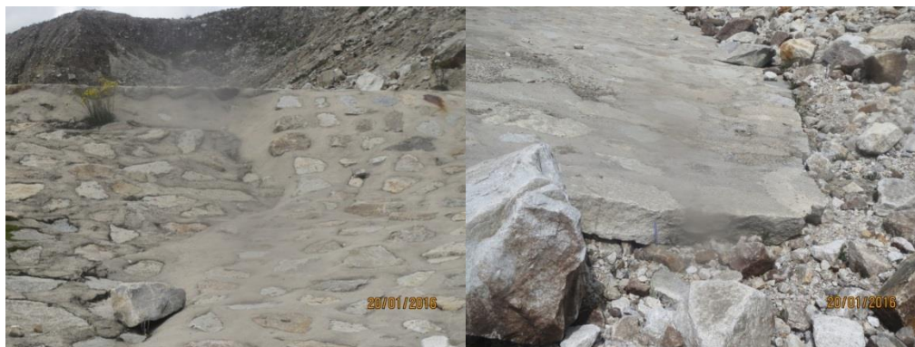
Foto N°14. Pie del talud del dique auxiliar, donde se observa levantada parte inferior de la loza, quedando la estructura vulnerable frente al proceso erosivo del agua.
