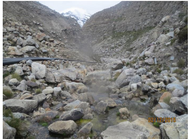
Foto N°13. La presencia de escorrentías que se observan cerca a los tubos del sifón son producto de los charcos de agua y posibles infiltraciones de la laguna
