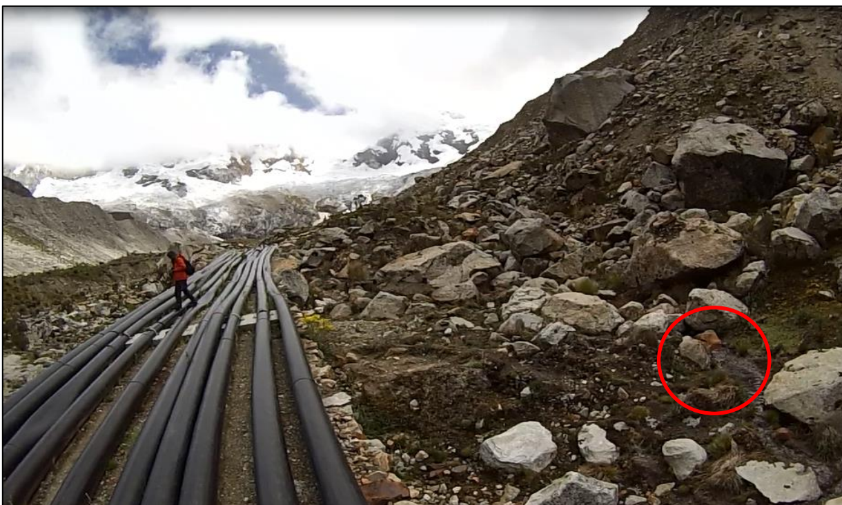
Fotos N°06, Vista de la tercera filtración ubicada cerca al sistema de sifonaje.
