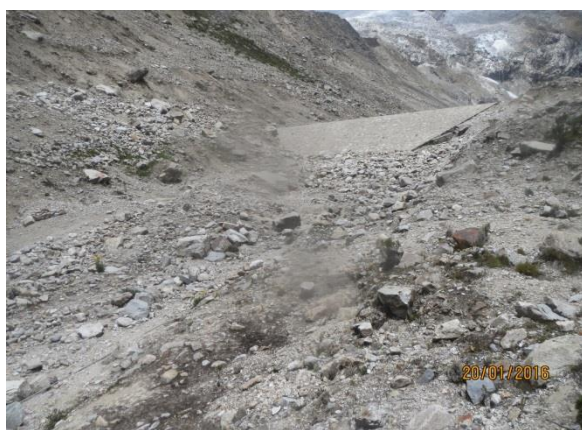
Foto N°20. Presencia del dique auxiliar junto a la morrena lateral derecha incorrectamente ejecutado, trabajado por encima de materiales inestables, sueltos e no consolidados
