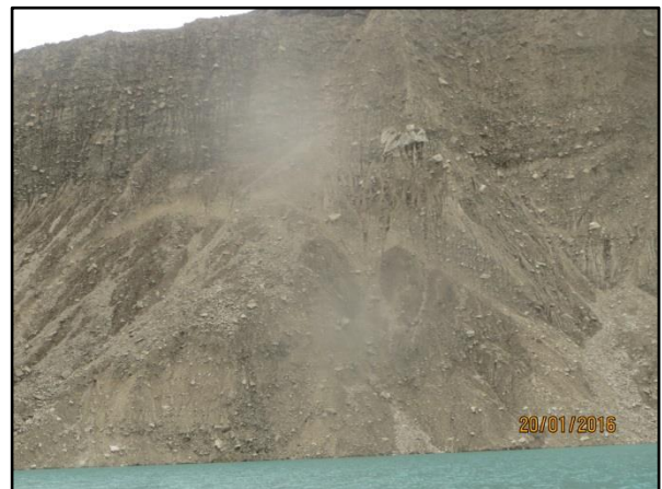
Foto N°10. La presencia de agua proveniente de la parte alta ha generado que gran parte del talud se vea afectado erosiones tipo surcos.
