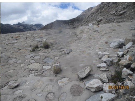
Foto N°22. Parte alta del talud del dique auxiliar, donde se evidencia aplastamiento de la loza, además de fisuras q, que determinan presencia de un probable asentamiento.
