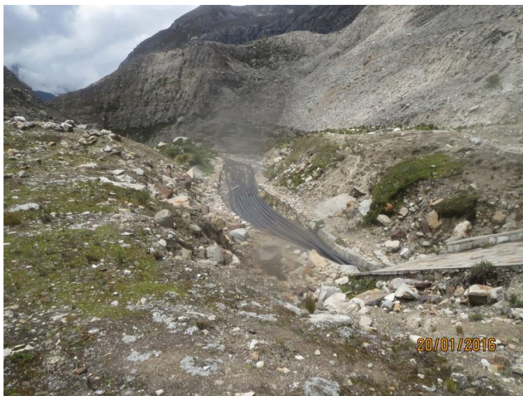
Foto N°21. Sector crítico debido a que el total de la tuberías del sifón pasan por suelos altamente inconsolidados, sueltos y susceptibles a erosión con taludes de pendientes mayores a 70° y alta humedad proclives a un deslizamientos que generaría la obstrucción del flujo de agua.
