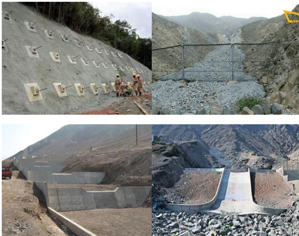
Figura 41. Muros anclados, barreras dinámicas y barreras de disipación de la energía aluviónica
