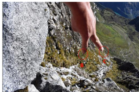
Fotografía N°8: Se muestra las filtraciones en la morrena terminal de la laguna Cancarcá.
