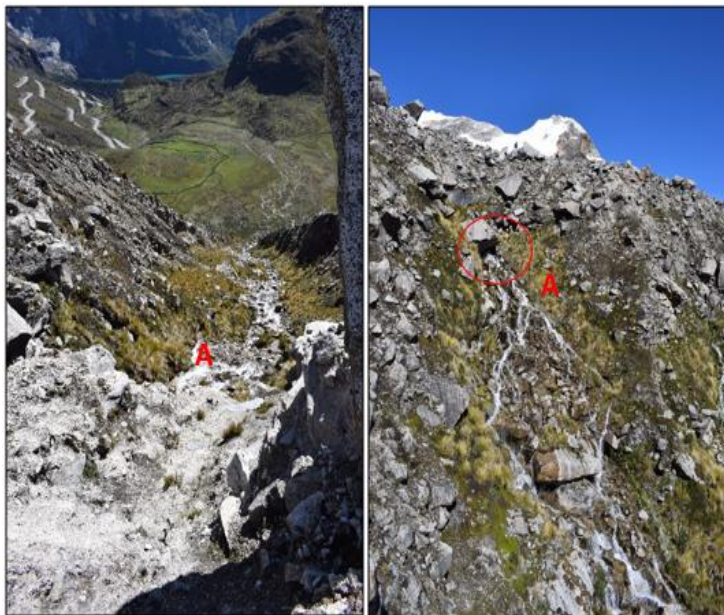
Fotografía N°6: Se muestra la parte posterior al dique de la laguna Cancarcá con la filtración de mayor importancia filtraciones en la morrena terminal de la laguna
